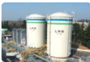
LNGプラント
