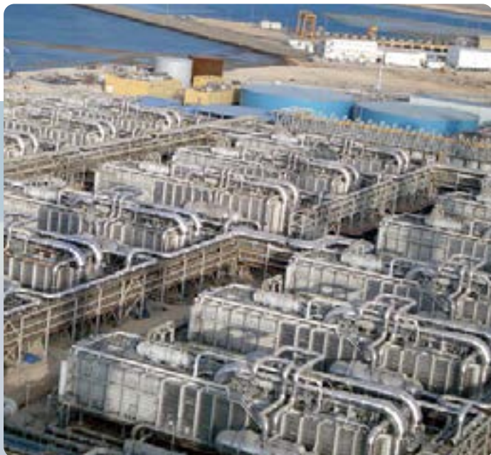
海水淡水化プラント
