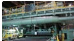
厚板工場：冷間矯正機
